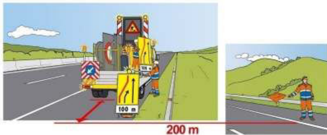
Figura 36 – chiusura della corsia di sorpasso: scarico ed installazione del segnale di esclusione della corsia sul margine destro
